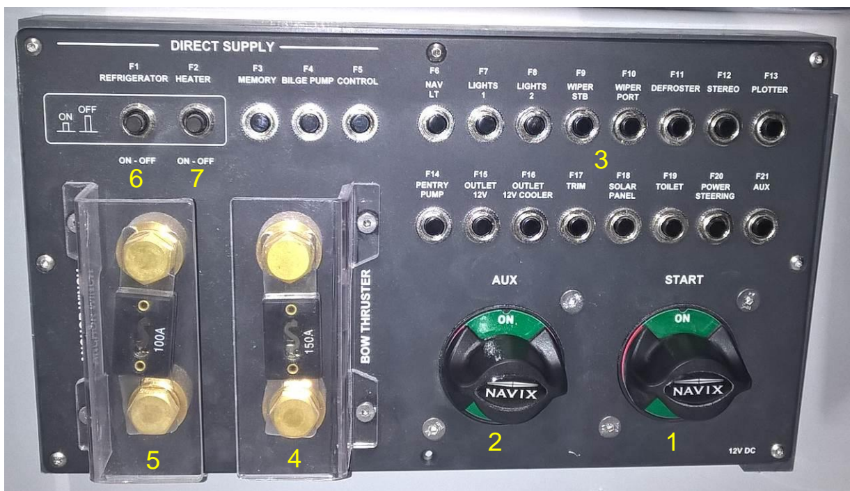
Kuva: Pääkytkimet ja sulakkeet
