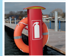
Versorgungssäulen Fernablesung online - Verwaltung
